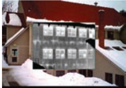
Abbildung 5-63. Die vielen warmen Bereiche an der vorderen Außenwand eines Geschäftsgebäudes werden durch mangelhaft installierte Glasfaserisolierung verursacht.
