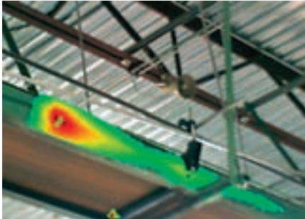
Abbildung 5-67. Ein gegen ein Deckenfördersystem reibender Riemen erzeugt einen Hot Spot in der Wärmesignatur. Der Riemen ist wegen eines in der Nähe befindlichen verschlissenen Rollenlagers falsch ausgerichtet. Erhöhte Reibung trug schließlich zur Überhitzung eines Antriebsmotors bei.
