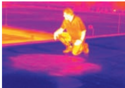
Abbildung 5-53. Ein Bereich feuchter Dachisolierung wird am frühen Abend, wenn die Bedingungen für die Erstellung von Wärmebildern optimal sind, als warme Stelle auf dem Dach angezeigt.
