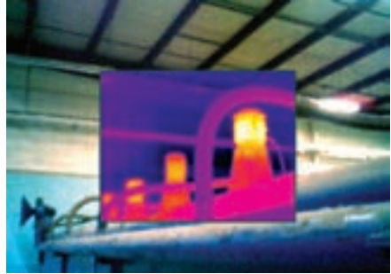
Abbildung 5-6. Beim Umlüftermotor auf der rechten Seite dieses Glühofens liegt möglicherweise ein Problem vor, da er heißer als die anderen Motoren ist.
