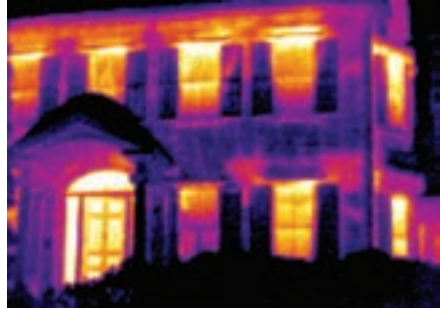
Abbildung 5-49. Bereiche mit fehlender Isolierung werden bei kaltem Wetter als warme Stellen an der Außenseite des Gebäudes sichtbar.
