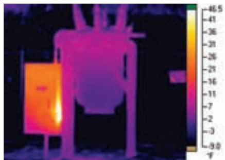
Abbildung 5-47. Mit Thermografie kann dokumentiert werden, ob eine Heizung in einem Schaltschrank normal funktioniert, um Kondensationsprobleme zu minimieren.
