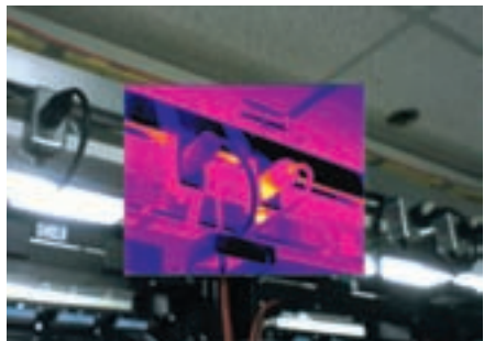
Abbildung 5-81. Der rechte Stecker einer Gruppe von Computerservern zeigt ein Wärmemuster, das auf eine hochohmige Verbindung oder ein internes Verkabelungsproblem hindeutet.
