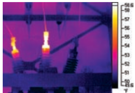
Abbildung 5-59. Zwei der sechs Durchführungskappen eines Öltrennschalters sind ungewöhnlich heiß und befinden sich in einem Zustand, der ohne Entdeckung und Reparatur hohe Kosten verursacht hätte.
