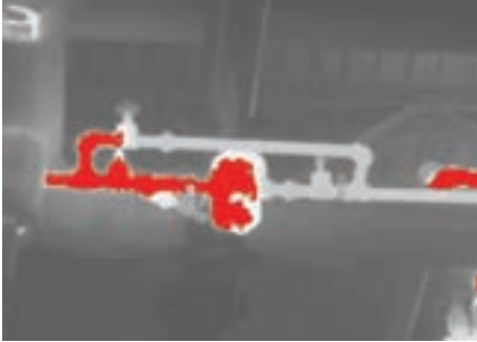
Abbildung 5-60. Ein ordnungsgemäß funktionierender Kondensatabscheider muss auf der Dampfseite wärmer als auf der Kondensatseite sein, wie es in diesem Bild der Fall ist.
