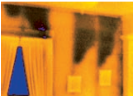
Abbildung 5-69. Mangelhaft installierte, lose eingefüllte Isolierung in einem vorhandenen Wandhohlraum kann sich setzen und ihren Zweck weniger gut erfüllen als ursprünglich vorgesehen war.
