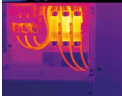
Wärmebilder, die fehlerhafte Anschlussstellen zeigen
