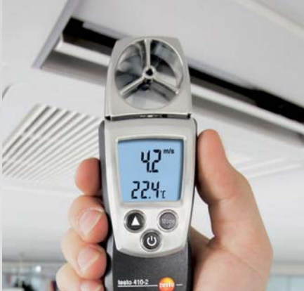
Strömungsmessung am Kanalauslass mit 40mm Flügelrad
