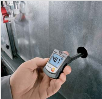
Kontrolle der Luftfeuchte im Klimakanal
