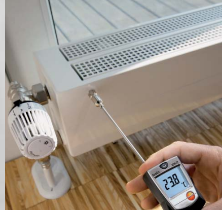
Oberflächen-Temperaturmessung an einem Heizkörper
